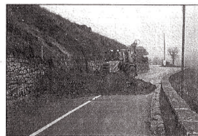
et le CD 15 après le passage des eaux.
